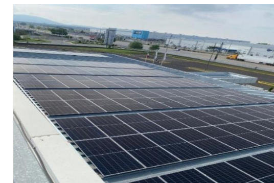
太陽光発電システム
