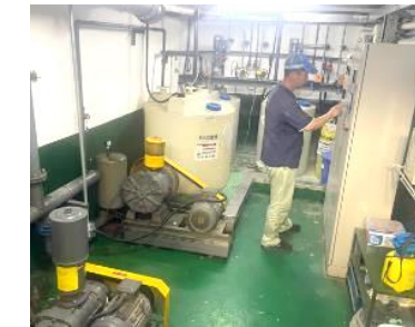
排水処理管理室
