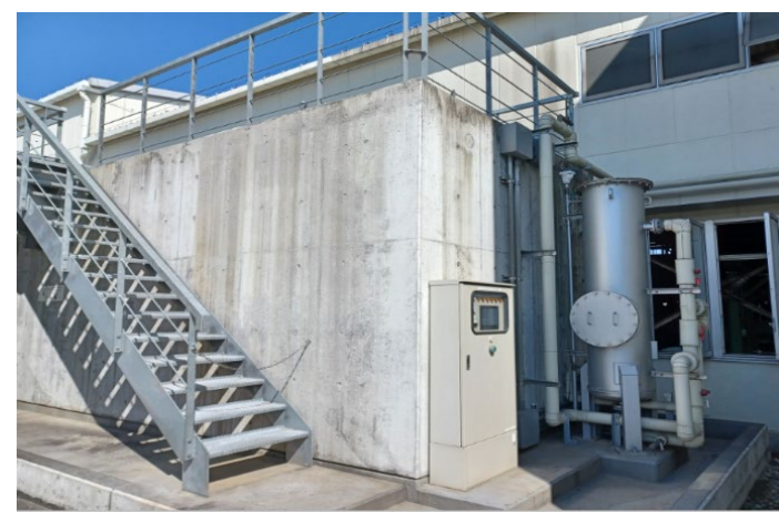
東日本ダイカスト工業(株)排水処理装置
